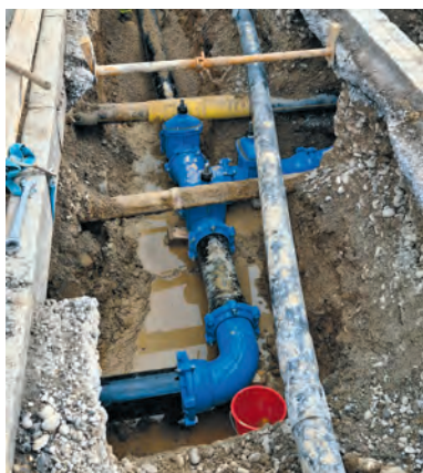
Dreier-Schieberkombination bei Einlenker Industriestrasse / Kapplerstrasse mit Abzweiger der Hauptwasserleitung.
